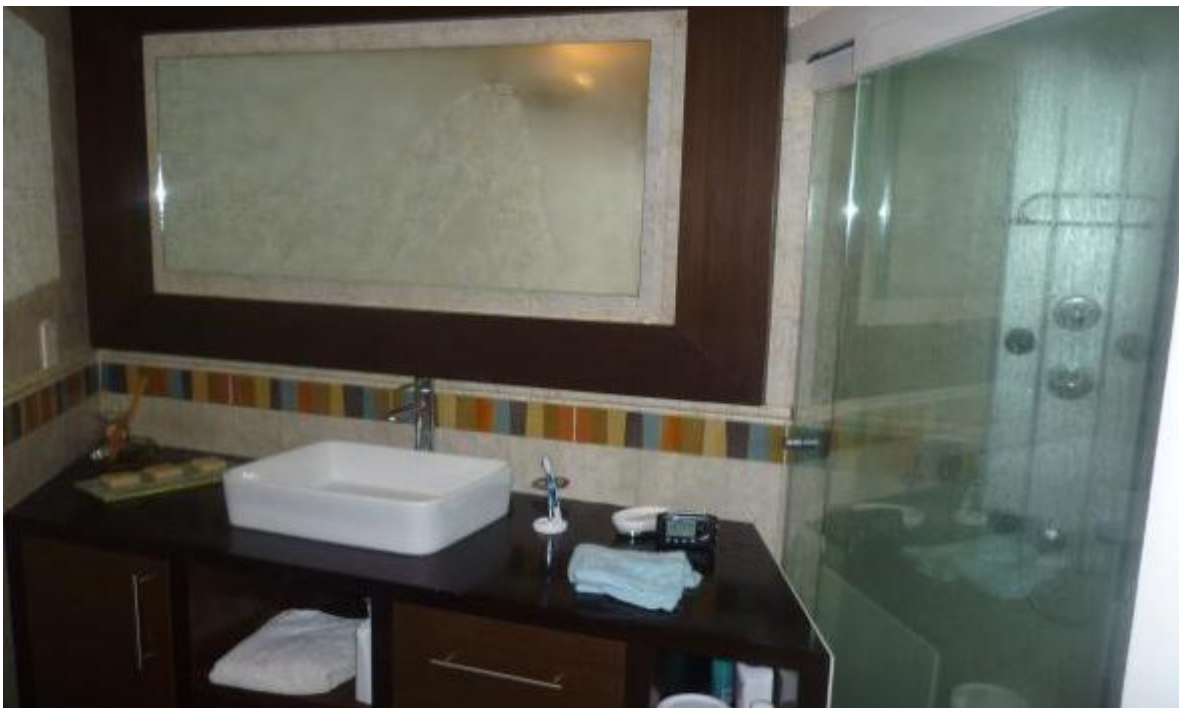
Baño de la Recamara 2, Completamente Nuevos todos sus acabados y hechos a la medida del Baño, con cancelos de Vidrio Templado, Espejo Flotado; Se cambió sistema hidráulico, sanitario y eléctrico
